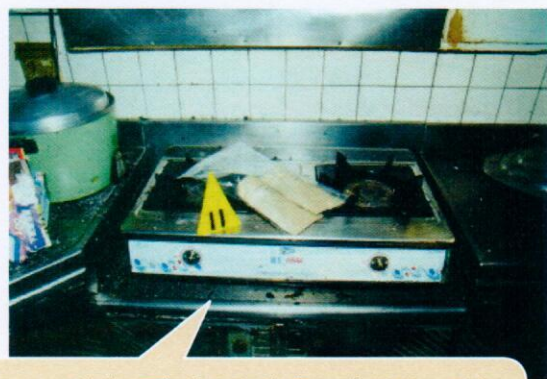
(八)一樓後方廚房瓦斯爐有一邊開啟，瓦斯外洩，係由進入現場的消防人員緊急關閉。
