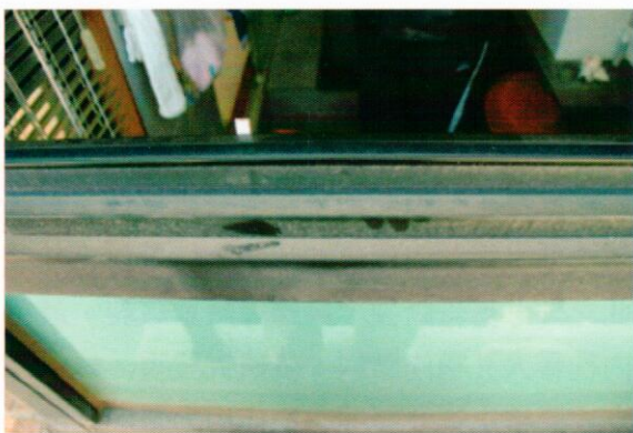
圖6、浴室氣窗邊框下緣外側指印
