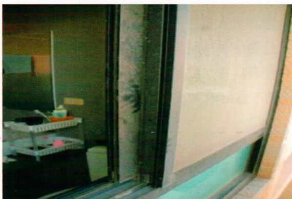
圖8、浴室紗窗邊框邊緣外側橫向指印
