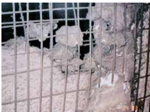
圖5、鋼筋混凝土樓板受燒後，混凝土嚴重崩裂之情形
