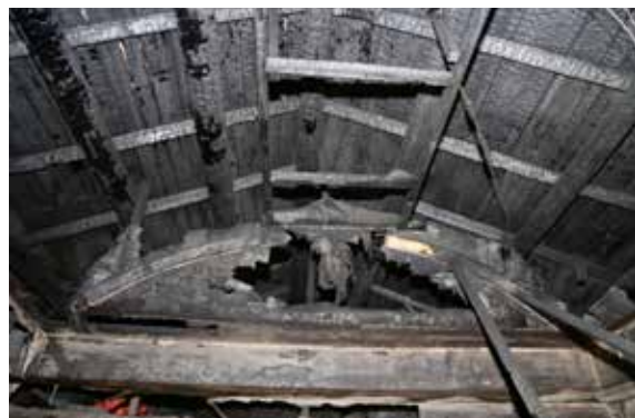
圖4、天花板下方橫向木支架因距離頂部熱氣層越遠，碳化越不明顯
